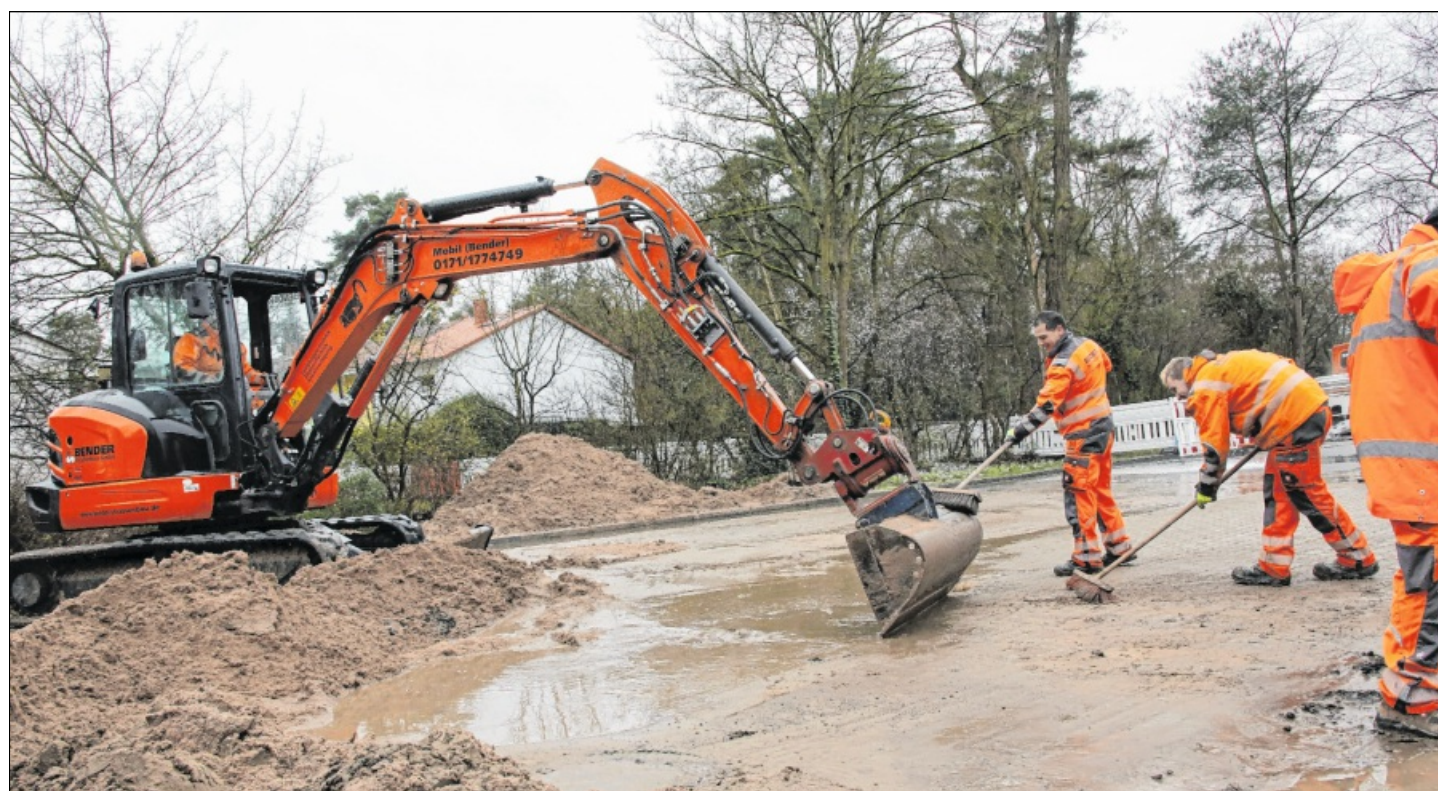
AUF DEN ROHRBRUCH in der Waldstadt folgen seit Samstag Aufräumarbeiten. Gestern wurde Restwasser abgepumpt, spätestens morgen soll das Rohr freigelegt werden. Immerhin halbseitig war die Königsberger Straße gestern schon wieder befahrbar. Foto: jodo
